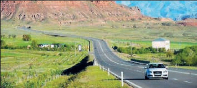
Qarabağ və Şərqi Zəngəzur iqtisadi rayonları ərazisində icra olunan yol infrastrukturunu layihələrindən biri olan Bərdə-Ağdam avtomobil yolunun tikintisi artıq yekunlaşmaq üzrədir.
